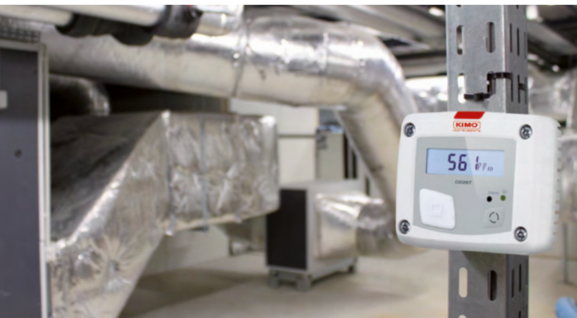
CO2ST fixé dans le local de traitement d'air d'une infrastructure industrielle.
